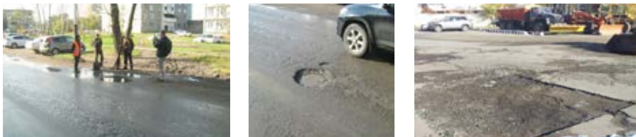
Рисунок 4. Места дефектов асфальтобетонного покрытия (выбоины)
